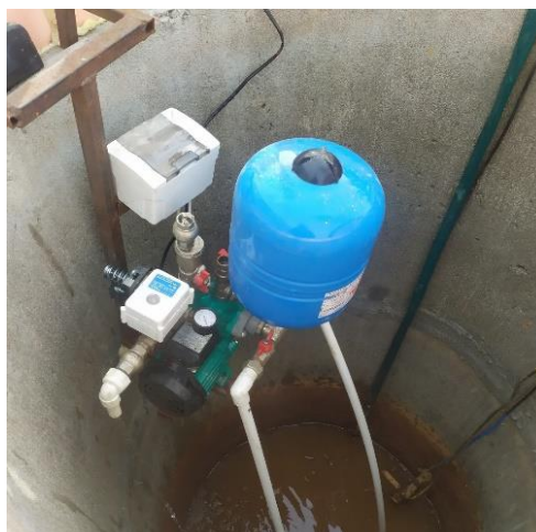
Рисунок 9. Апробация разработанных погружных мембранных модулей для очистки колодезной воды
