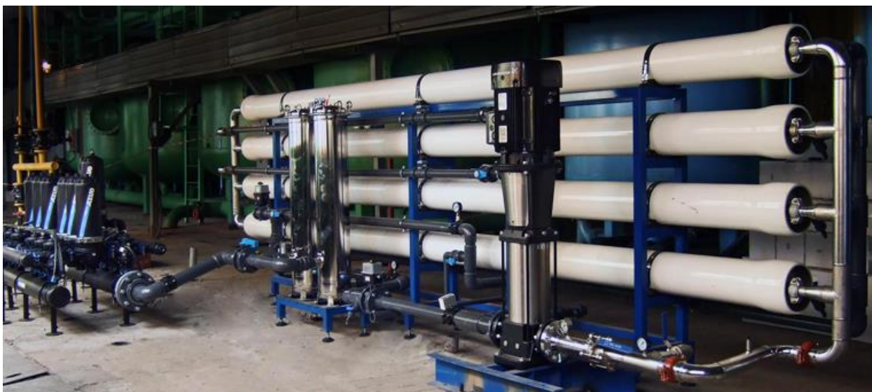
Рисунок 6. Установка нанофильтрации для очистки речной воды на полоцкой ТЭЦ
