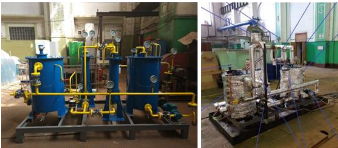
Рисунок 1. Вид стенда до и после проведенной доработки
